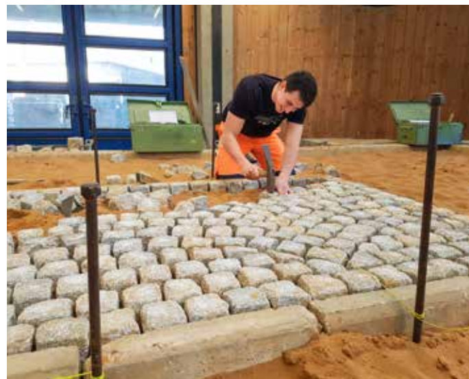
Felix Heinloth studiert Bauingenieurwesen an der OTH Regensburg und wird in der Firmengruppe Max Bögl zum Straßenbauer ausgebildet.
